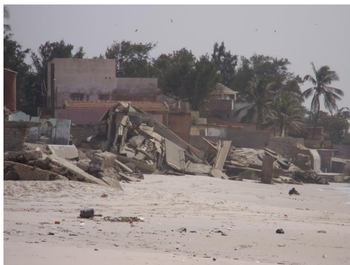
Fig. 13 - Conséquences de l'érosion côtière, Petit Mbaou. © I. Sidibé, 2013.
